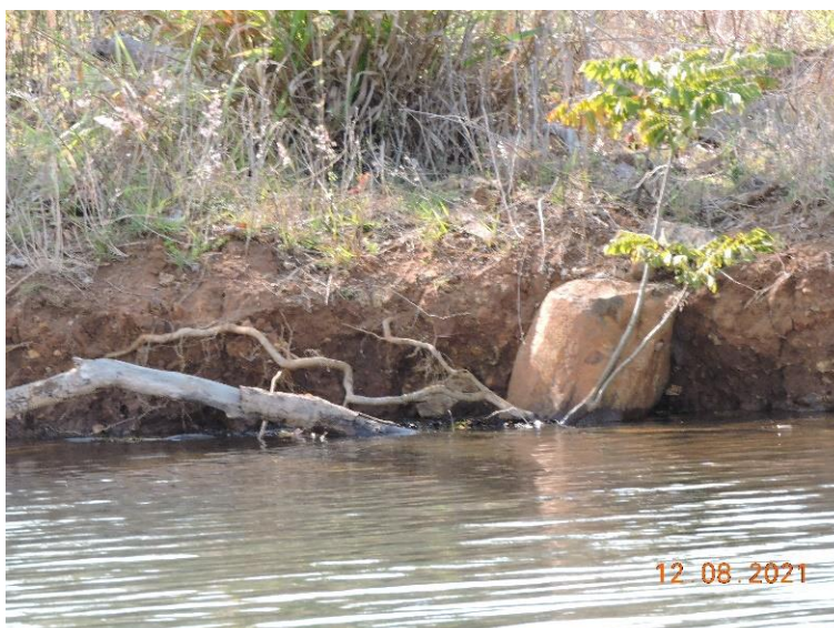
Figura 4. Erosão laminar no ponto 1, localizado na margem do reservatório. Programa de Prevenção e Controle de Erosão e Assoreamento do Reservatório da PCH Bandeirante, Água Clara, MS. Agosto de 2021.
