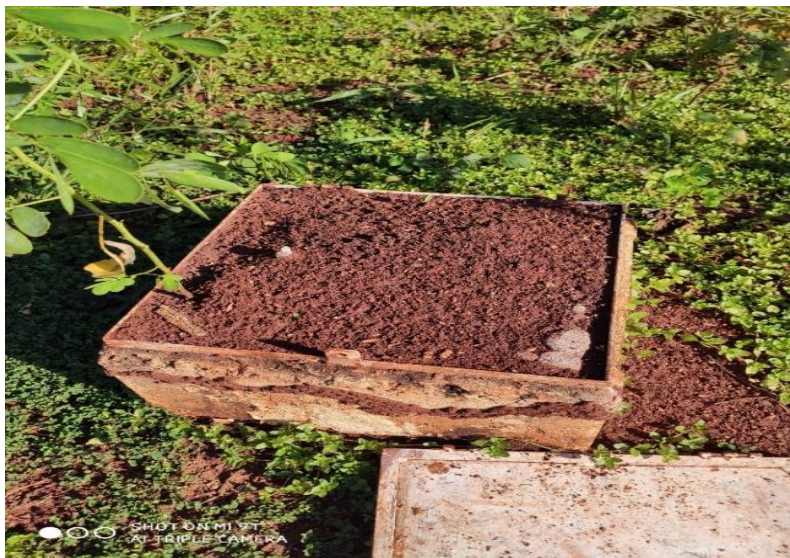
Figura 5.2-1: Caixa de poço piezométrico coberta por cupinzeiro na PCH Bandeirante, Água Clara, MS.
