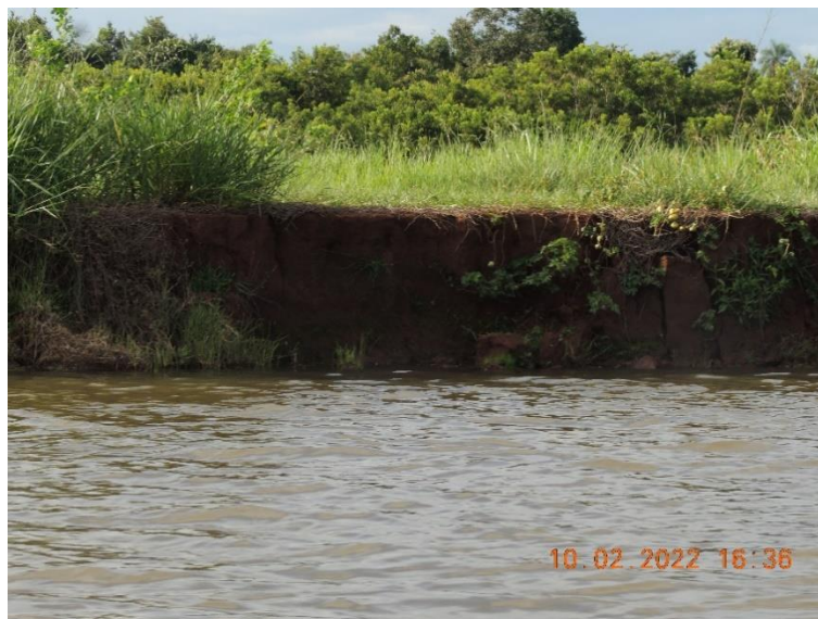
Figura 13.3.2-1: Erosão laminar no ponto 2, localizado na margem do reservatório. Programa de Prevenção e Controle de Erosão e Assoreamento do Reservatório da PCH Bandeirante, Água Clara, MS. Fevereiro de 2022.
